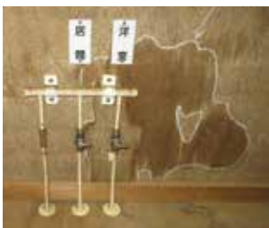
物置の灯油配管周辺の油じみ
